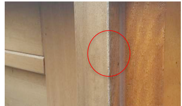
Exemplo de verniz danificado em canto vivo
